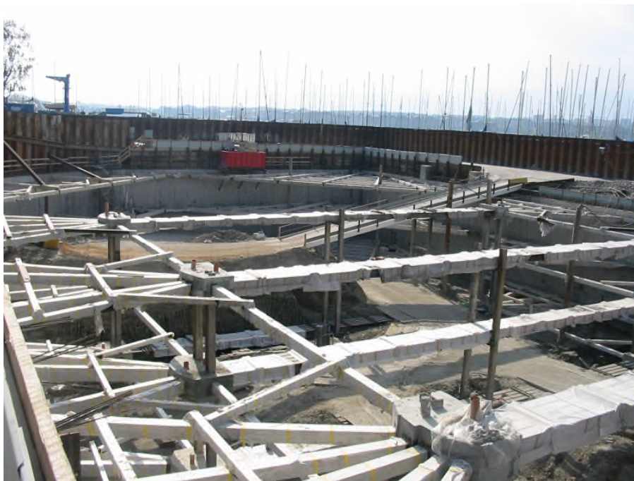
Deux rangs d'étais posés sur 4 au total - Au fond batardeau et voiliers
