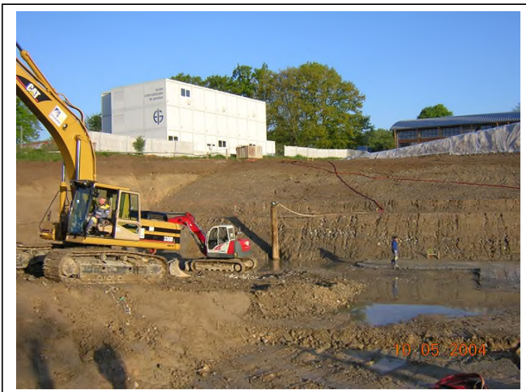
Terrassement avec puits de rabattement de la nappe Fouille partiellement inondée après un orage
